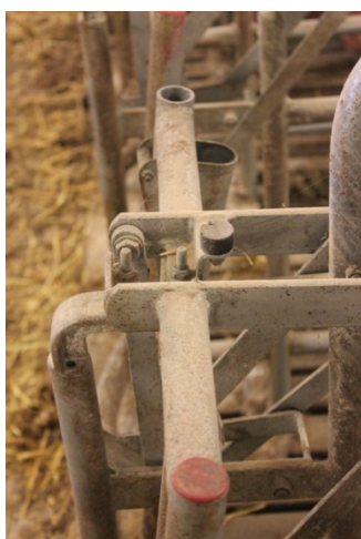
Billede 20. Manglende plastikelement, Egebjerg ACO Funki)
